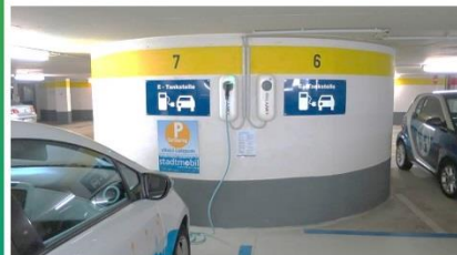
E-Carsharing und Ladestation im Parkhaus
