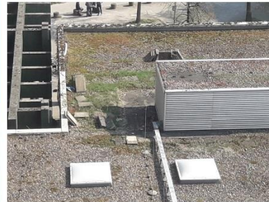
Wildwuchs auf dem Dach des Geomatikums Foto: eigenes Foto
